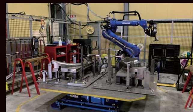
ヘミングロボット設備
